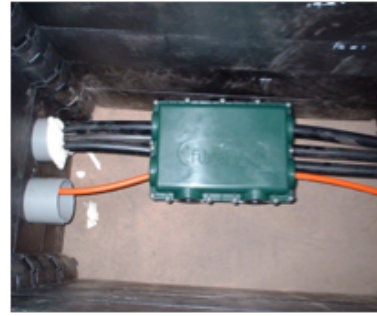
Abzweiger in Kleinschacht
